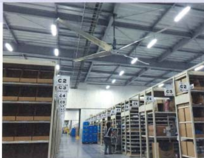
倉庫内の空気を循環させて室温を安定させるために、風速7mの風を送れるファンを設置する大手通販企業の物流センター。ほこりやカビを防ぐ対策にもなる
